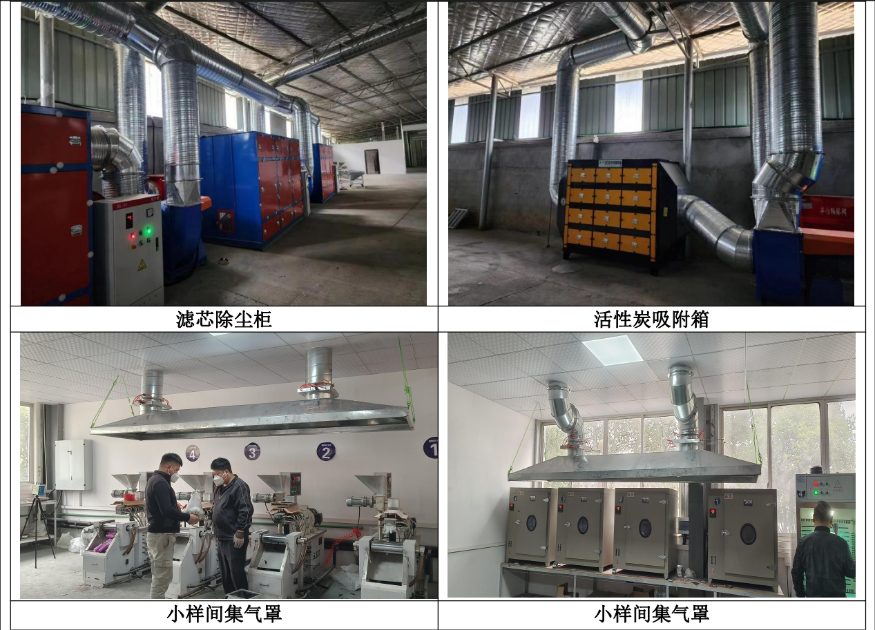
图 3-1 废气产污结点和处理设施现场图
