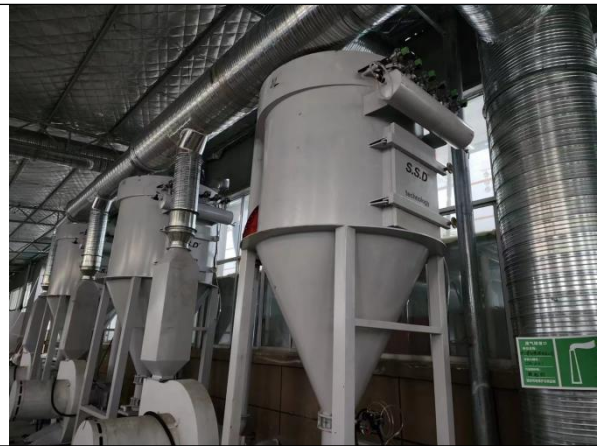
脉冲除尘器及 DA001 排气筒
