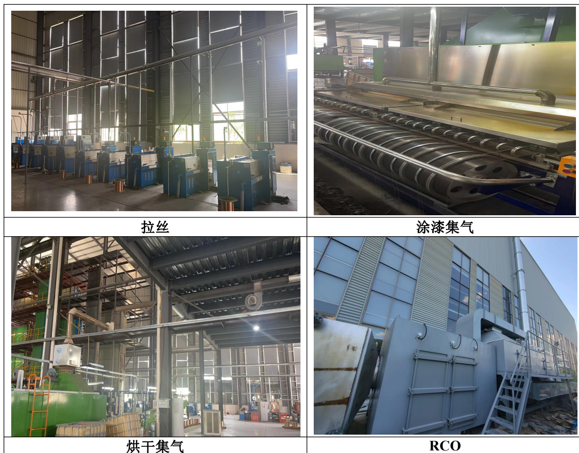
图 5-1 废气产污节点和处理设施现场图
