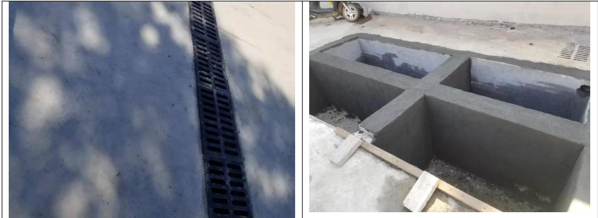
图 3-2 项目雨水收集和隔油池现场图
